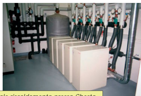
Locale riscaldamento presso Chestonag AG con cinque pompe di calore di 14 kW ognuna (foto M. Eberhard)
