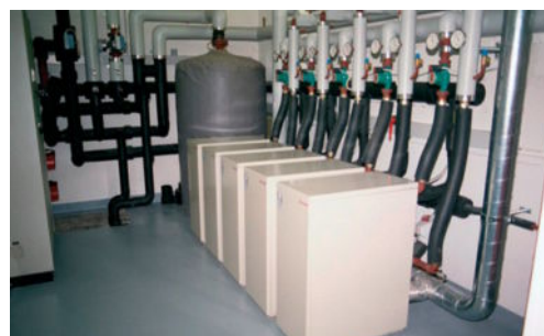
Local de chauffage chez Chestonag AG avec cinq pompes à chaleur de 14 kW chacune (photo M. Eberhard)
